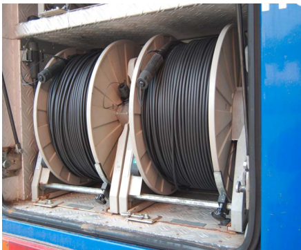
Kabeltrommeln des Ü-Wagens
